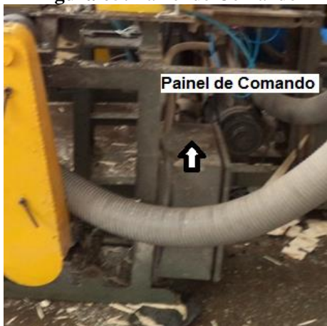
Figura 05: Painel de Comando
