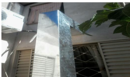
Figura 6: Área externa da casa onde foi instalado o duto de insuflação
